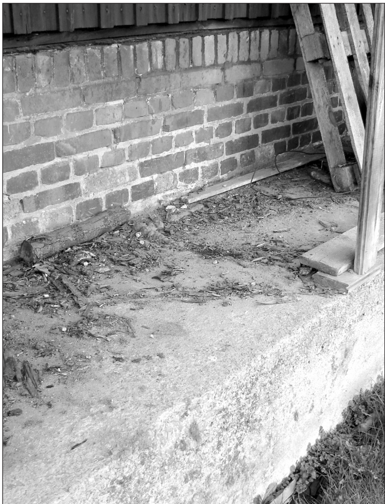
Do szamba domku fińskiego w trakcie kontroli nikt zaglądał nie będzie – jeśli jednak w studzience jest przyłącze, to wiadomo, iż takie szambo jest fikcją
