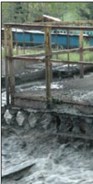
Obecny stan oczyszczalni ścieków „Ziemowit” przeznaczony w projekcie do kompleksowej modernizacji.
