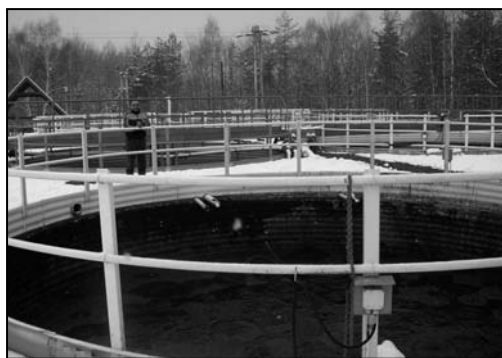
Oczyszczalnia ścieków w Hołdunowie
