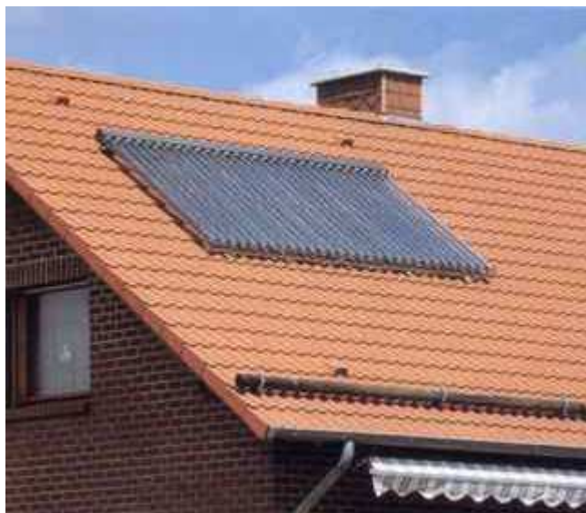
Rysunek 3-7 Przykład zamontowanych kolektorów słonecznych na domku jednorodzinnym
